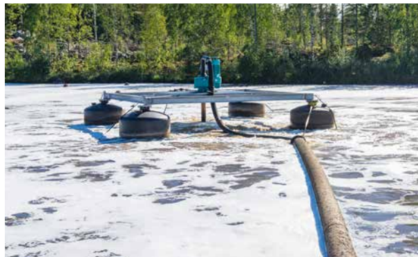
El HYPERCLASSIC ® -Sistema de Agitación y Aireación Flotante en una planta de tratamiento de aguas residuales de estanques en Suecia
