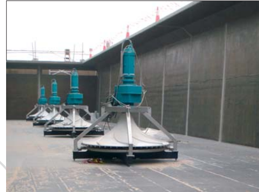
Sistema de agitación y aireación HYPERDIVE® , durante su montaje en una planta de tratamiento municipal en Medio Oriente
