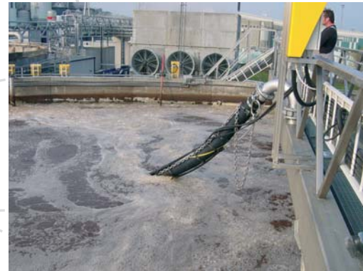
Sistema de agitación y aireación HYPERDIVE® en funcionamiento en una planta de tratamiento industrial en Suecia (industria papelera)
