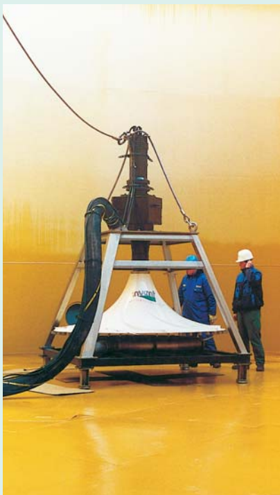
1 sistema de agitación y aireación HYPERDIVE® de un total de 4 en una planta de tratamiento industrial en Holanda (industria petroquímica)
