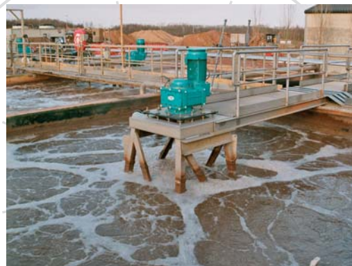
4 sistemas de agitación/aireación HYPERCLASSIC ® en una planta industrial de tratamiento de aguas residuales en Bélgica (industria de alimentos)
