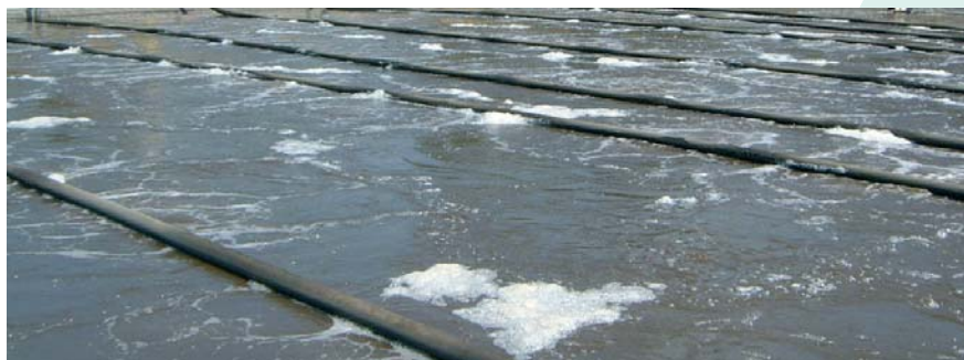
Sistema de aireación E-FLEX®-FLOAT en un tanque de lodos activados
