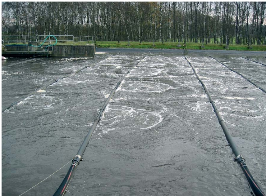
Cadenas de aireación E-FLEX®-FLOAT en una laguna de oxidación
