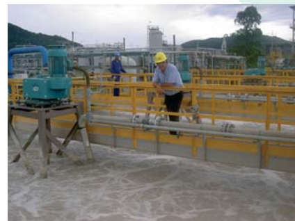
5 sistemas de agitación/aireación HYPERCLASSIC® en una planta industrial de tratamiento de aguas residuales en Brasil (industria química)
